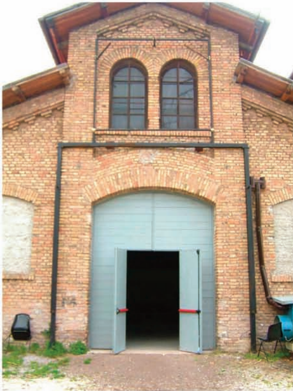
Sala A: Unloading door
