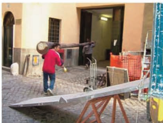
Teatro Argentina: Unloading door
